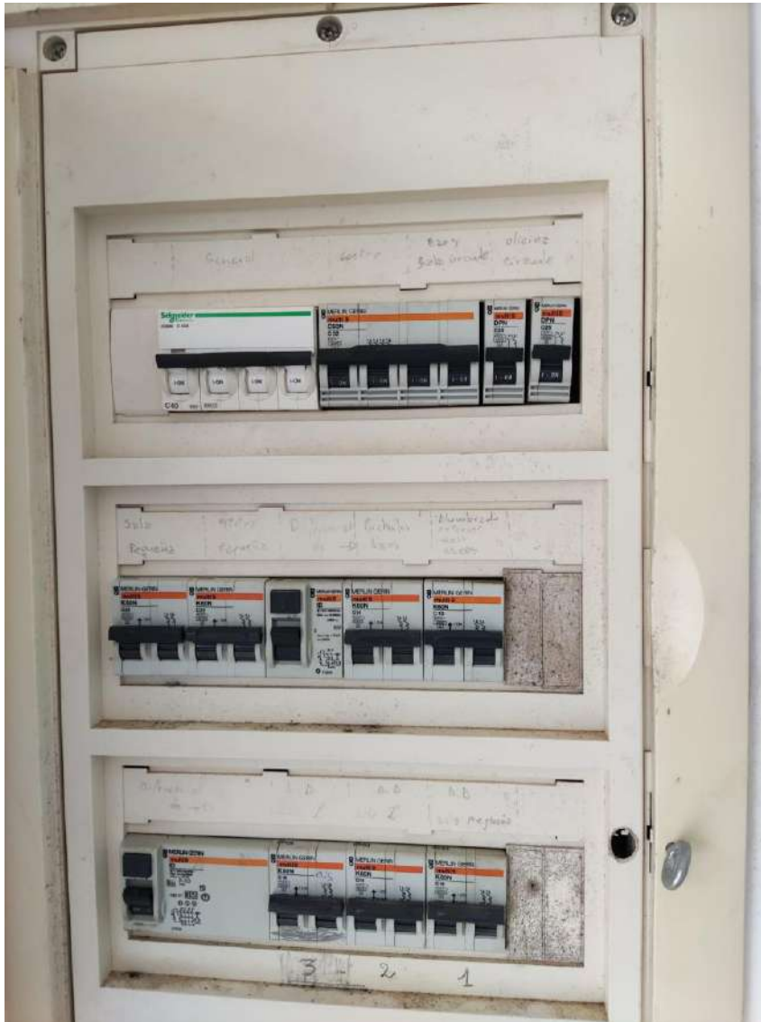
Quadre general a connectar la instal·lació fotovoltaica
