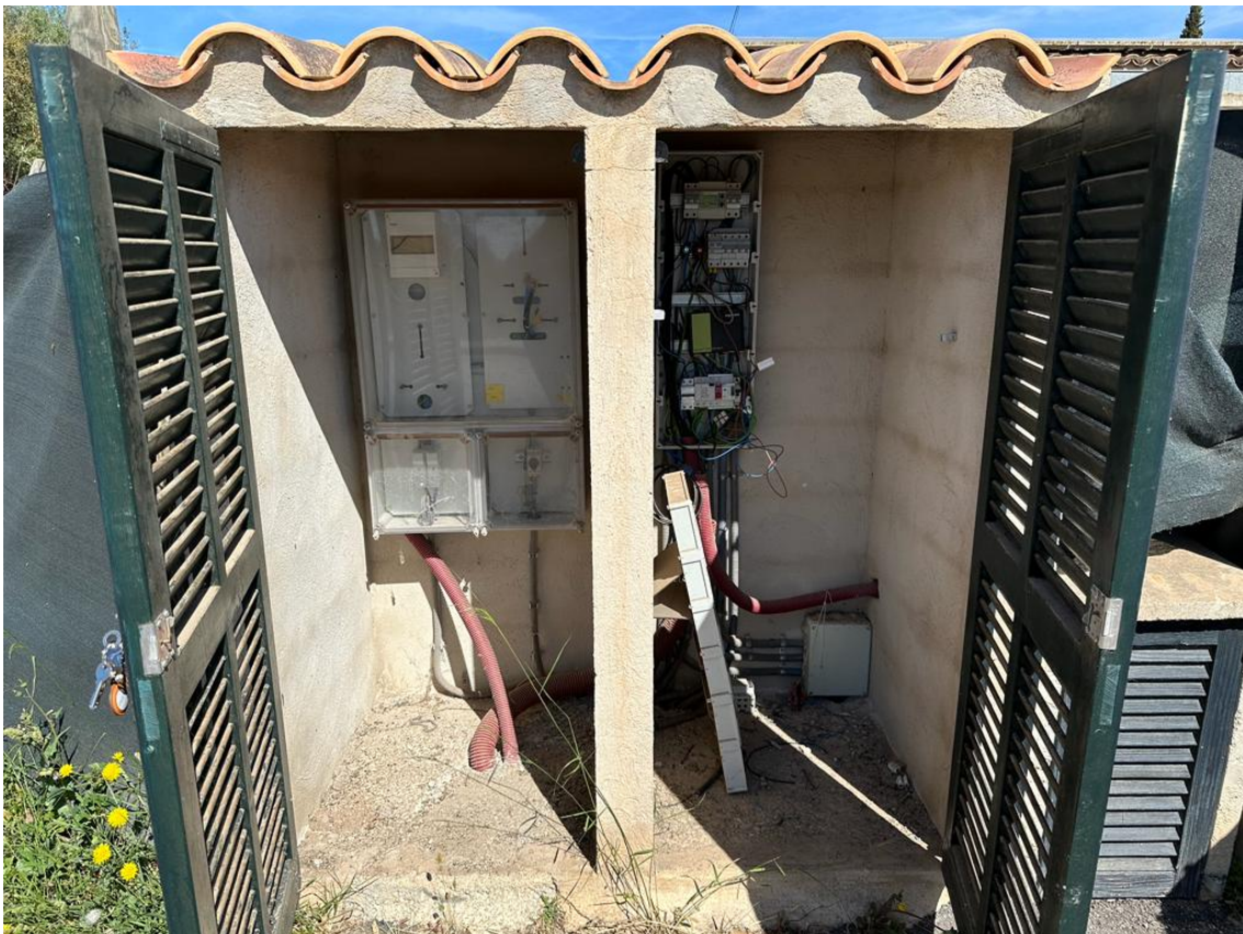
A la dreta, quadre general a adequar i a on es connecta la instal·lació FV projectada
